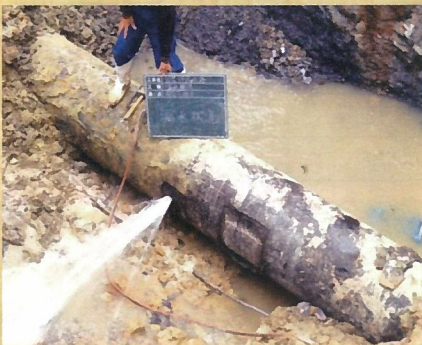
○管の腐食による漏水（前歴宮良川地区）
